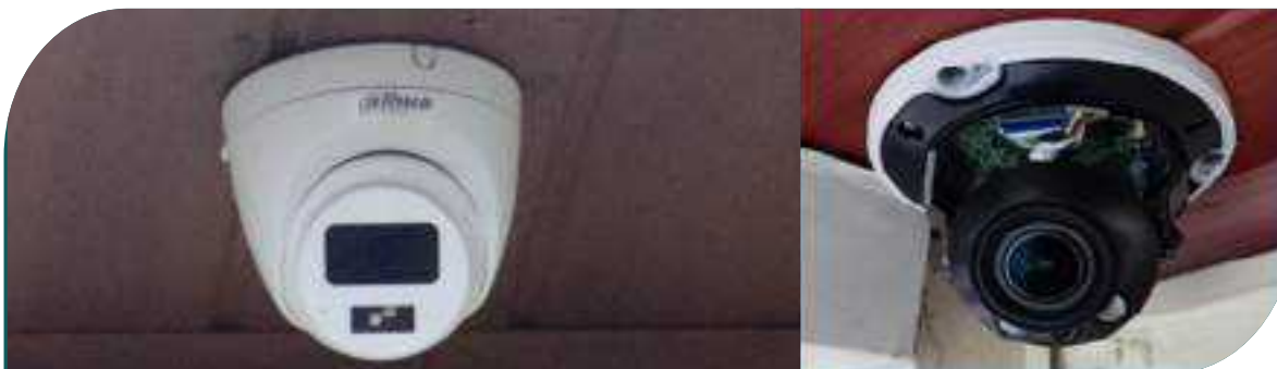
Mantenimiento preventivo-correctivo del sistema CCTV.
