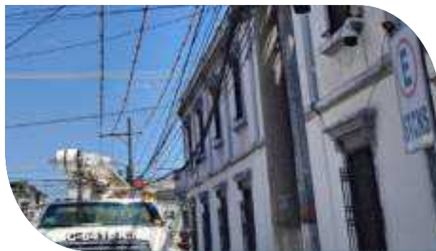
Sistema de aislamiento de las líneas eléctricas
