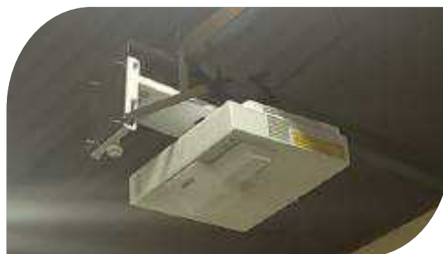
Instalación de nuevo proyector interactivo en salón.
